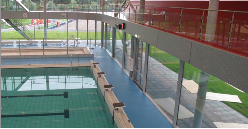
Het 25 meter bad van het Ronald McDonald Centre Only Friends heeft een zeer duurzaam ventilatiesysteem
